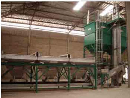
3 Wägebältern Weighcont Mischer und Small Bag Abfüllmaschine
